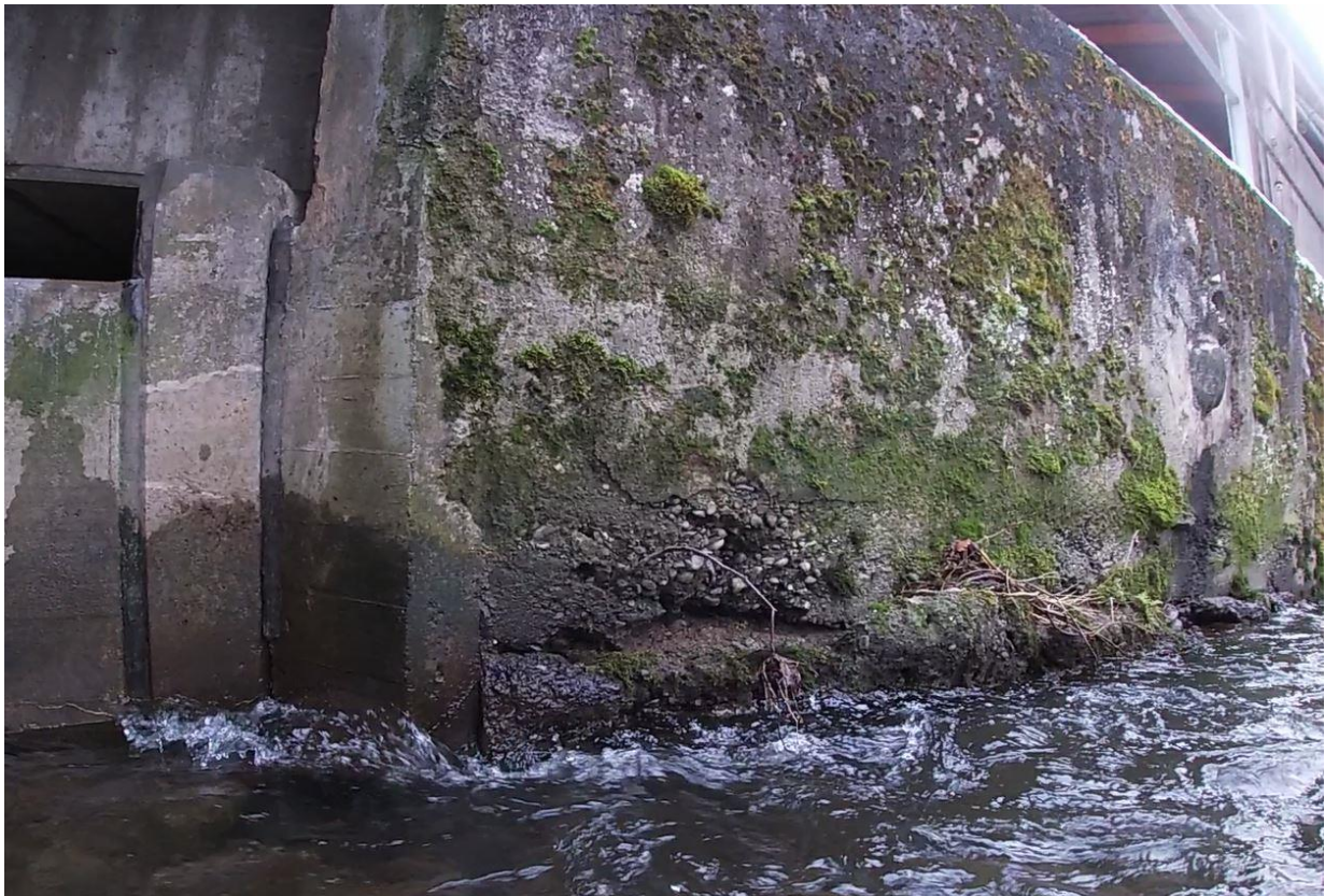
Abbildung 4: Ausbrüche bei der bestehenden Ufermauer direkt unterhalb der Holzikerstrassenbrücke (Bild: Kissling + Zbinden AG).
